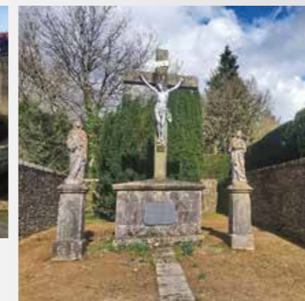
Calvaire de la Garenne / La Flocellière : remise en état d'une partie du mur d'enceinte et suppression de la végétation
